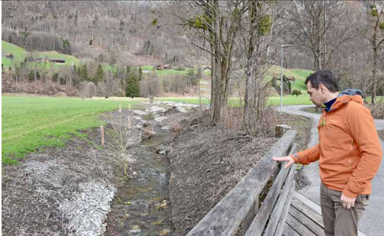
Naturmah: EW-Chef Christian Dürr wirft im März einen Kontrollblick auf die Revitalisierungsarbeiten im Bereich Valungen. Bilder Hans Bärtsch
