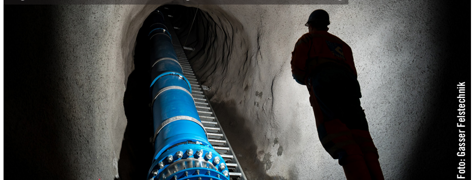
Der abschließende Abschnitt der insgesamt 1,3 km langen Druckleitung im Stollen wurde mit einer Steigung von 55° Grad ausgeführt. Über 1.100 Stufen bildet der Aufstieg über 275 Höhenmeter den kürzesten Weg zwischen Zentrale und Wasserfassung.
